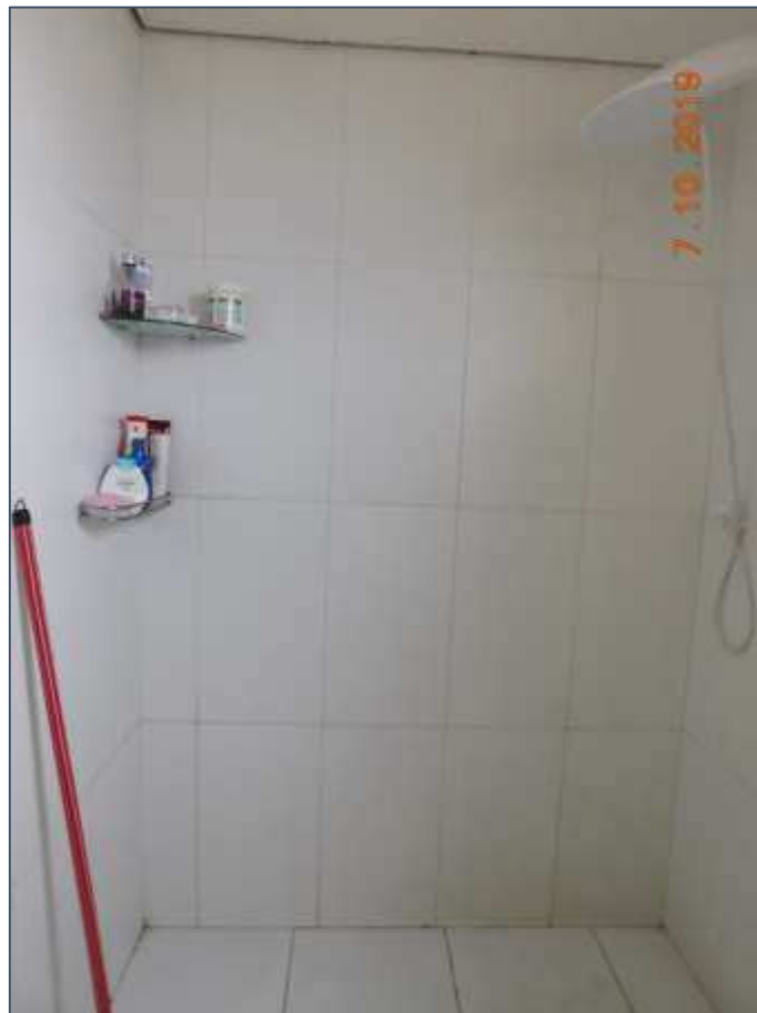
Foto nº 19 - 13º andar - banheiro
